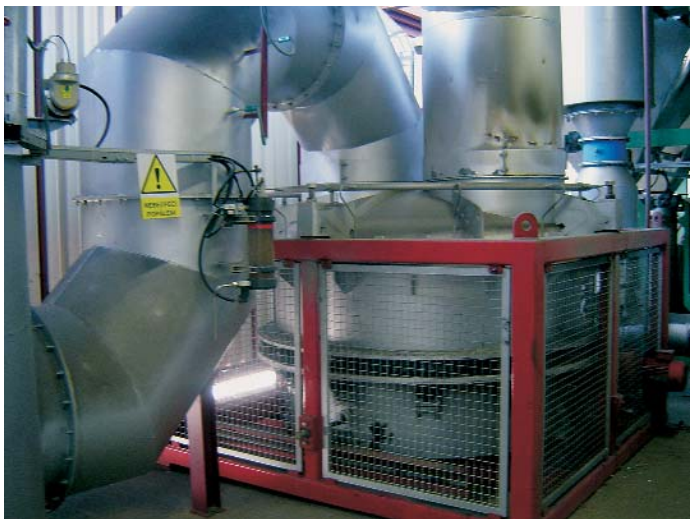
Bild 3: Wärmerückgewinnung hinter der TNV mittels EcoReg®
