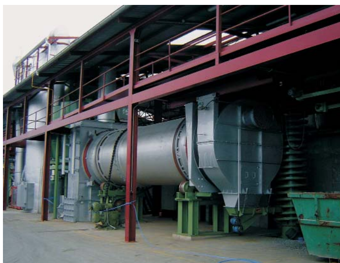
Bild 2: Drehtrommel der Spänetrocknungsanlage Fig. 2: Rotary drum of the drying swarf plant
